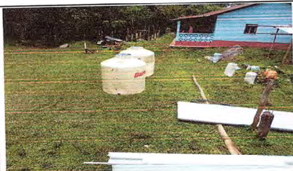
Foto 3: Tinacos respectivos para almacenaje de agua
